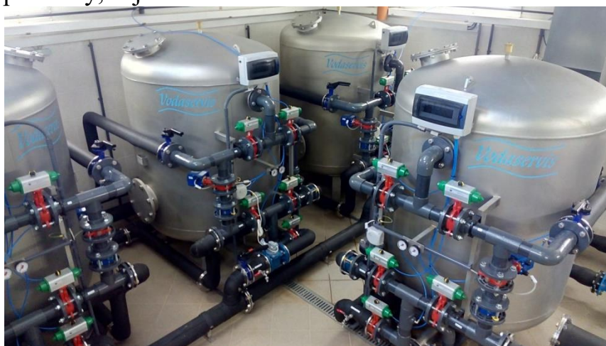
Obrázek 115: ÚV Pustiměř - technologie tlaková filtrace.
