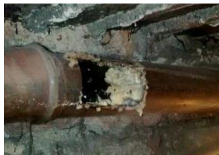
Obrázek 7: Zanešené potrubí. Zdroj: http://kanalizace.instalace-charvat.cz/fotogalerie/ .
