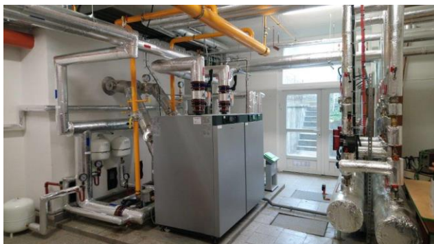
Obrázek 4: Nové kondenzační kotle. Foto: Lukáš Peška.
