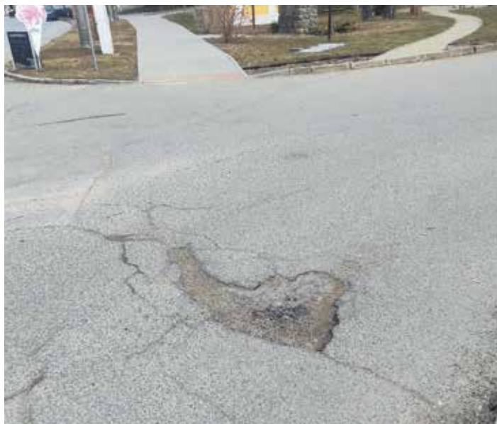
Stav před opravou.
